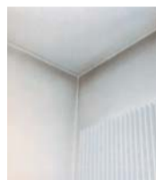
Der „Fogging-Effekt“ macht sich u.a. durch verschmutzte Zimmerecken bemerkbar.
