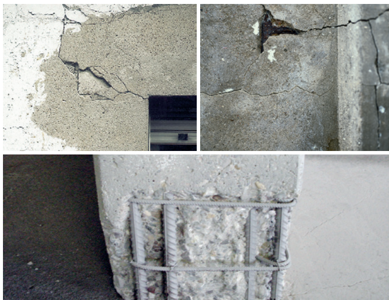
Altbeton Schäden mit intakter Tragfunktion zur minimalinvasiven Sanierung. Der flächig aufgetragene Betonersatz darf die Verformung des Bauwerks nicht behindern.
