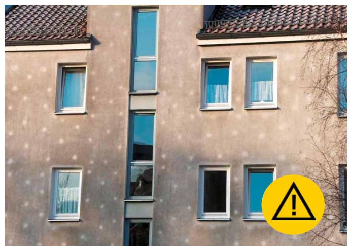
Werden Dübel nicht wärmebrückenfrei oder falsch gesetzt, zeichnen sich die Dübelköpfe an der Fassade ab.
