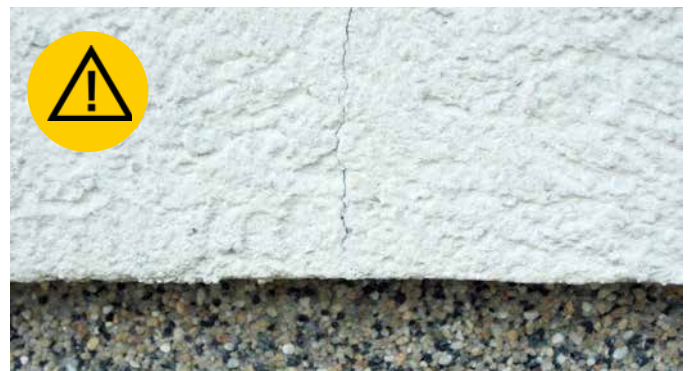
Bei nicht fachgerechter Ausführung des Sockelanschlusses können im Stoßbereich zwischen den Profilen Risse entstehen.
