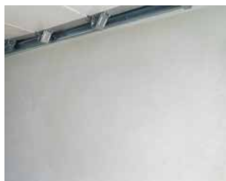
links: eine Garagenwand fünf Jahre nach der Sanierung, die bis 2019 trotz mehrerer Sanierungsversuche immer wieder vom Schimmel befallen wurde (Bild rechts).
